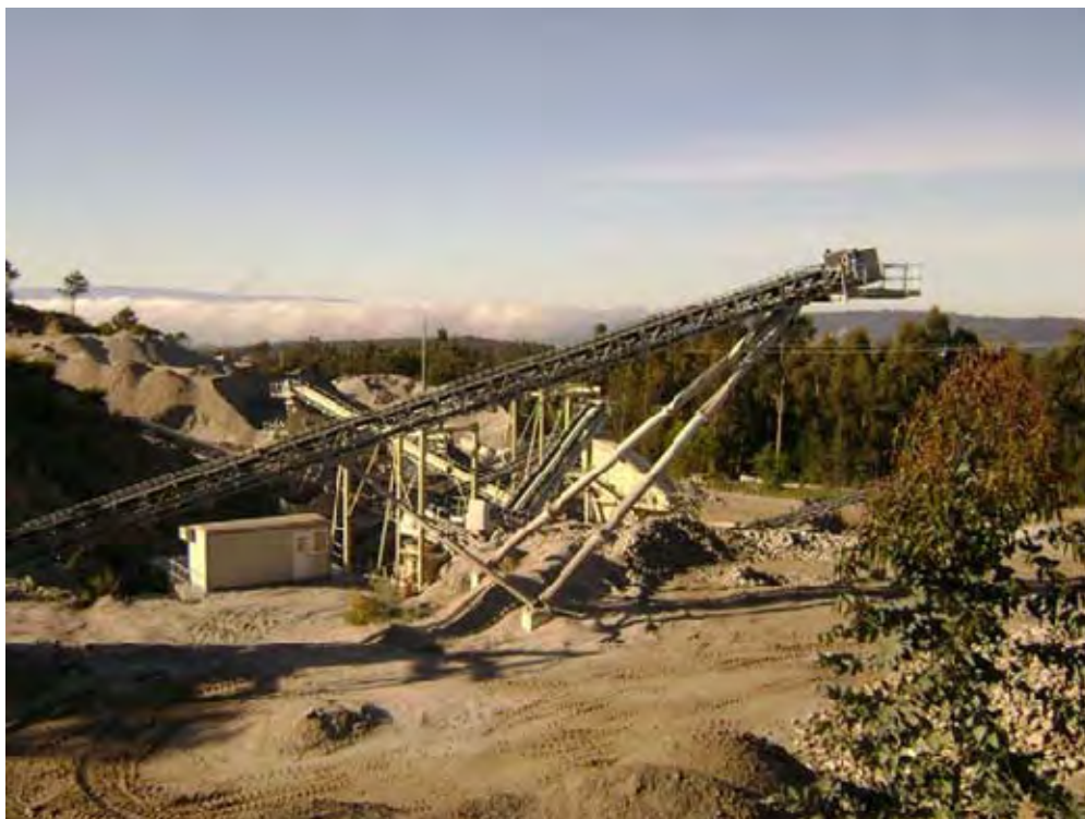
Fotografia 2: Vista parcial da instalação de britagem
